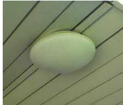
Valaisin sisäänkäynnin lipassa
