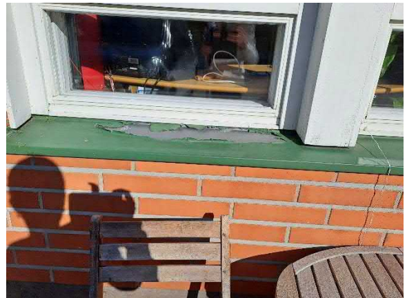
Ikkunapellityksessä maalipinnan vaurioita
