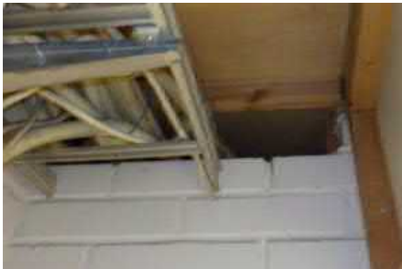
Avoin läpivienti keskuskomerossa
