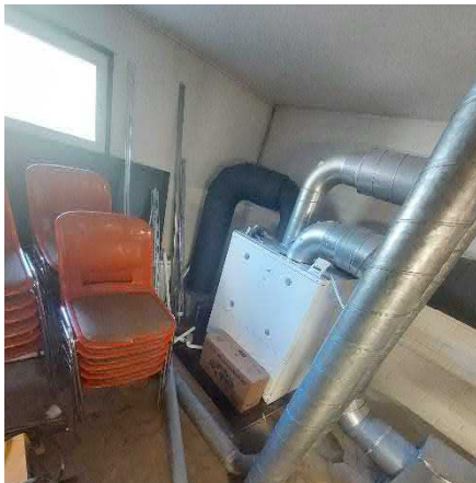
TK02 Sosiaali- ja toimistotilojen ilmanvaihtokoneen ympärillä paljon tavaraa.
