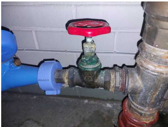
Vuotava vesimittarin sulkuventtiili, alkuperäinen.
