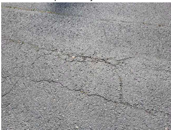
Asfalttipinnoissa tyypillistä halkeilua
