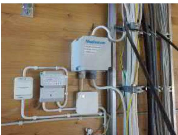
Pakokaasuimurin sähköistystä kalustohallin parvella
