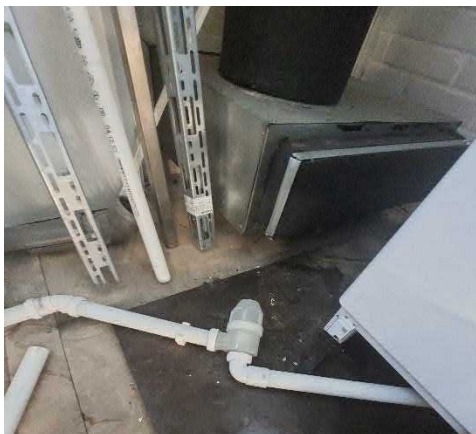
Väärin asennettu IV-koneen kondenssiviemäri.
