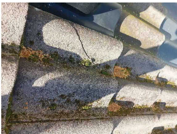
Kattotiilissä paikoin halkeamia ja sammalkasvustoa
