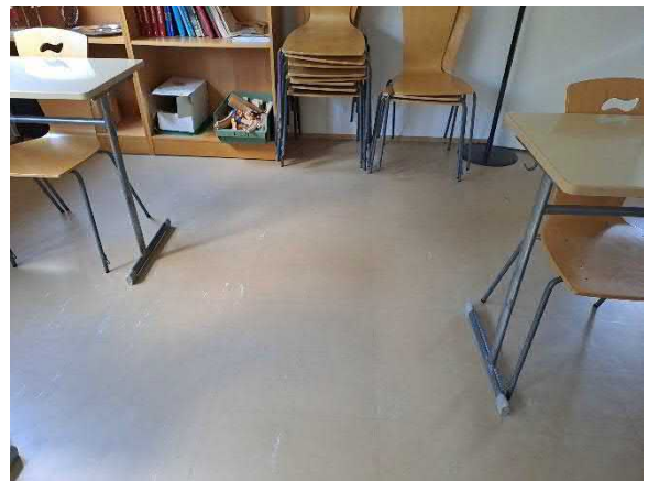
Koulutustilan lattiapintamateriaalina vinyylilaatta
