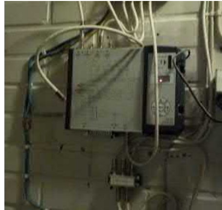
Antennivahvistin ja -jaotin teknisessä tilassa
