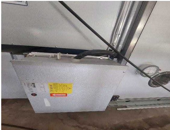
TK01 ilmanvaihtokoneen sähköinen lämmityspatteri.
