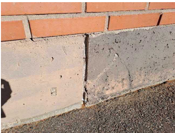
Sokkeleiden elementtisaumat tulee uusia
