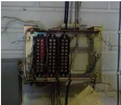
KytKentärimat teknisessä tilassa
