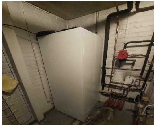
Tekniseen tilaan sijoitettu sähköinen lämpimän käyttöveden varaaja.
