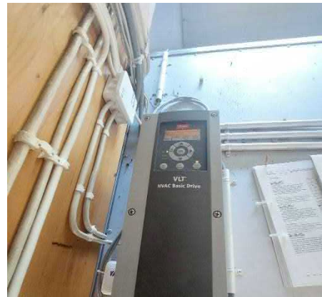
Ilmanvaihtokoneen puhaltimen taajuusmuuttaja.
