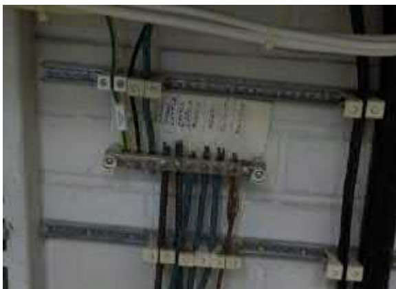
Maadoituskisko pääkeskuksen yhteydessä
