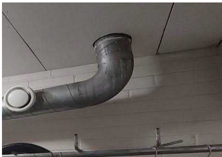
Ilmastointikanavan tiivistämätön läpivienti.
